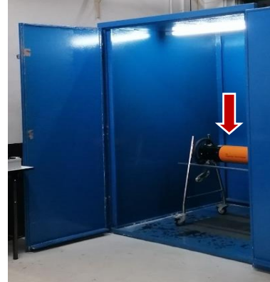
รูปที่ 12(2) ลักษณะการติดตั้งใช้งานเครื่อง X-Ray Research Radiography ในตู้ปิดมิดชิด ที่มา กองตรวจสอบทางนิวเคลียร์และรังสี ปี พ.ศ. 2561
